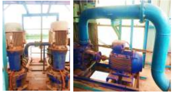
Pompes de captage
